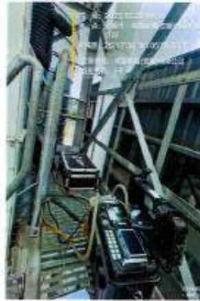
布袋除尘器排气筒
