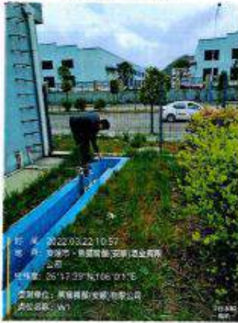
污水处理站出口
